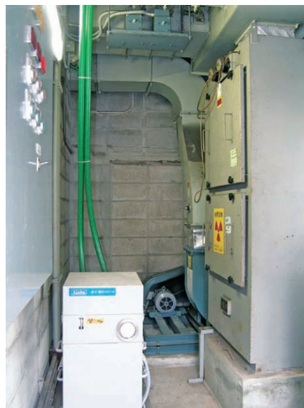
RI 排気設備。RI 使用施設の空気は、すべてフィルターを通して放出される。右側手前のフィルターユニットで空気を浄化し、奥の排風機で屋外へ排気している。左側のガスモニターで、排気中の放射能濃度を常に測定している。
